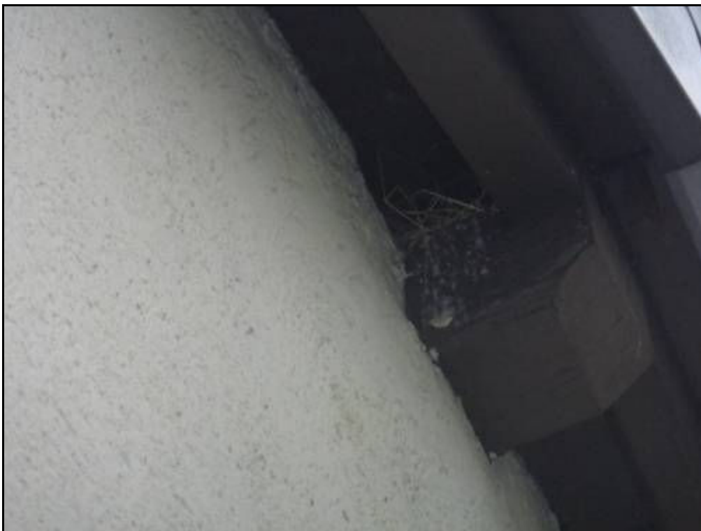
Abb. 7: Sicht auf ein Nest an einer Dachsparre
